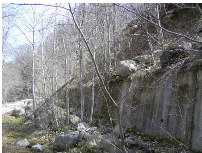
Текущи срутищно-ерозионни процеси при бетонов подпорен зид от 80-те години състояние към края на март 2009
